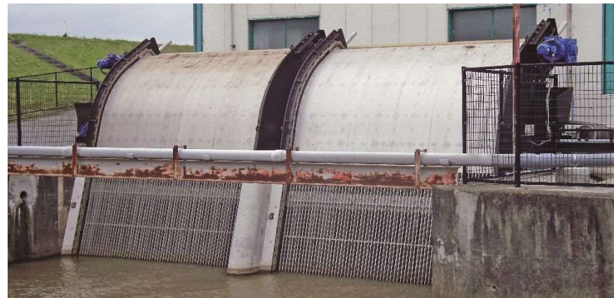
仙台機場除塵設備 (宮城県) 水路断面幅4.0m×高2.95m、2基 ロータリーレーキ式 2007
