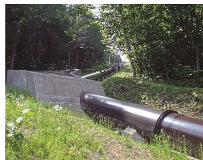
葛根田第一発電所水圧鉄管 (東北電力株) 延長423m 内径1600mm~1200mm 2003
